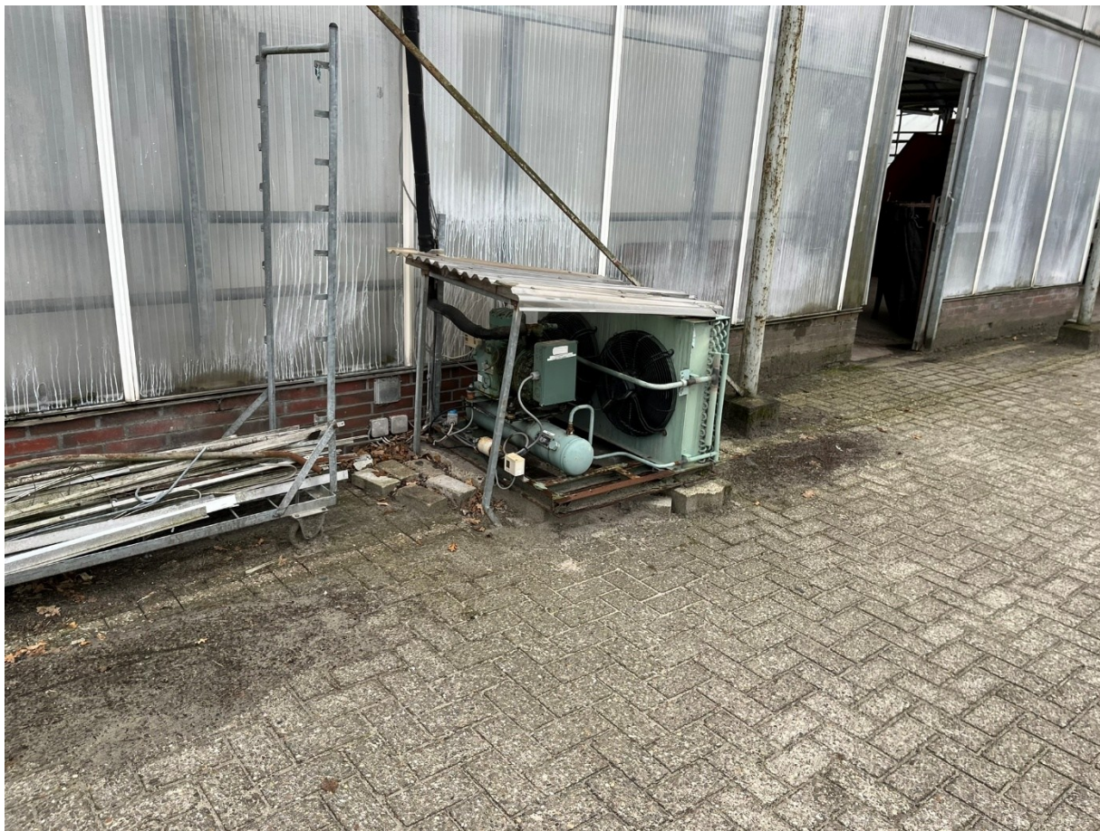
Abbildung A1: Foto des Außenaggregat Kühlzelle.
